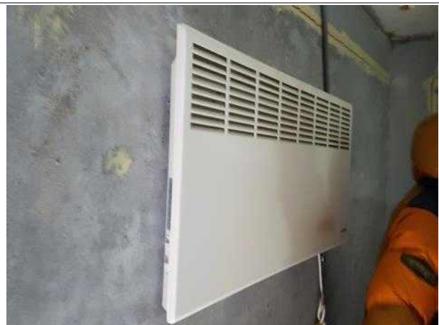
<물탱크실 동파방지 방열기 설치>
